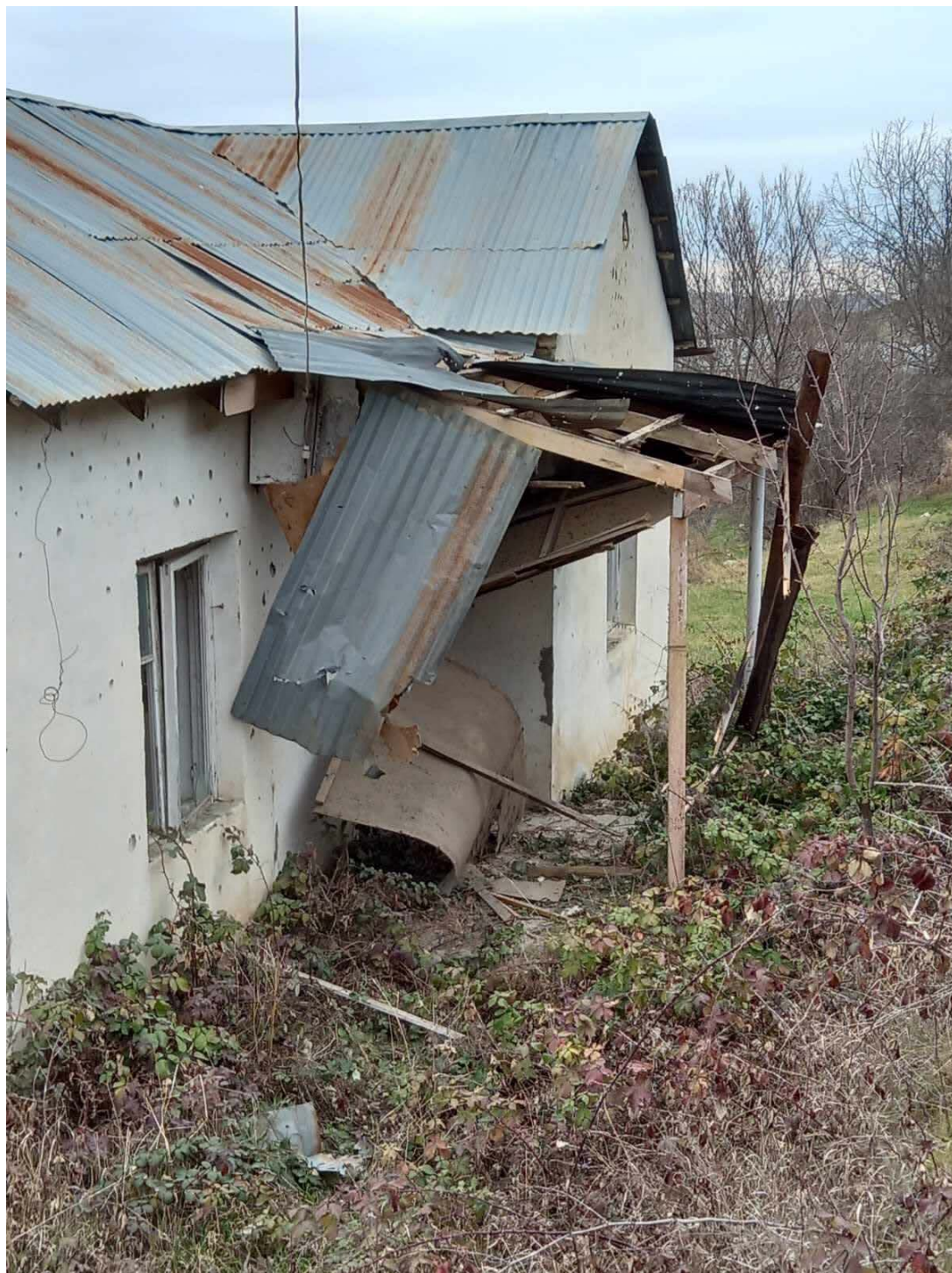
Рис. 2. Поврежденная общинная постройка в селе Парух
